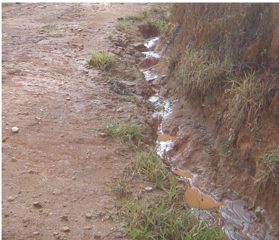
Figura 36 - Ilustração da irregularidade do aprofundamento ao longo do canal em condições reais de campo.
