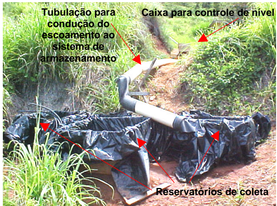
Figura 9. Sistema de condução da água da calha até o local para armazenamento do escoamento.
