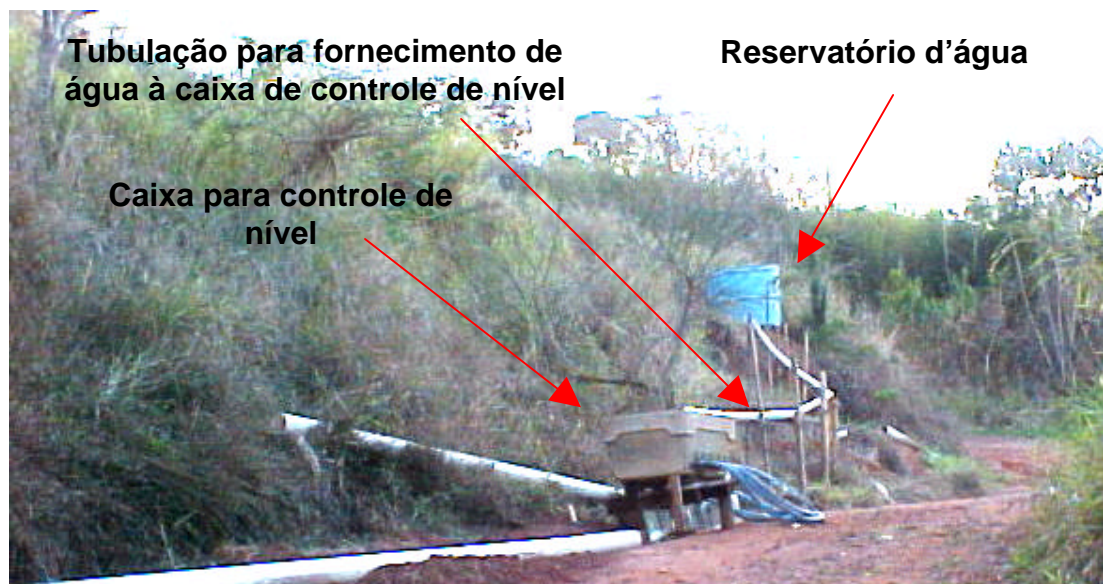
Figura 8. Caixa d'água para o fornecimento de água para a realização dos testes e tubulação de ligação à caixa para controle de nível.
